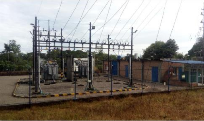
Ilustración 7 Gamma4 Subestación la hormiga
