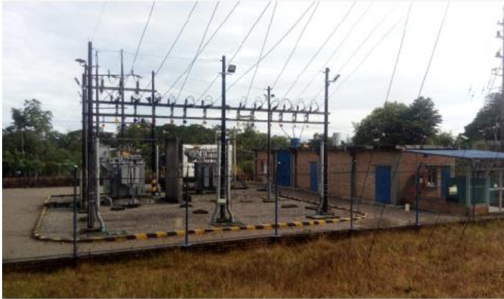
Ilustración 7 Gamma4 Subestación la hormiga
